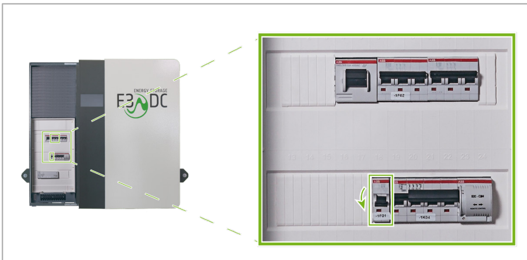
Abb. 169: LS-Automat für interne Versorgung ausschalten (1F01)
