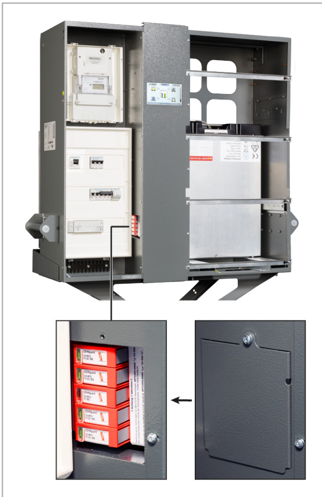
Abb. 132: DC-Überspannungsschutz im AC-Anschlussraum
