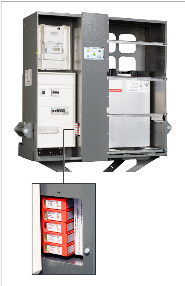
Abb. 126: DC-Überspannungsschutz im AC-Anschlussraum
