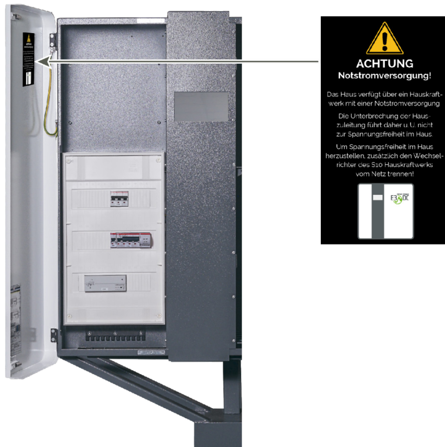
Abb. 8: Aufkleber „Achtung Notstromversorgung“ im S10 E anbringen
