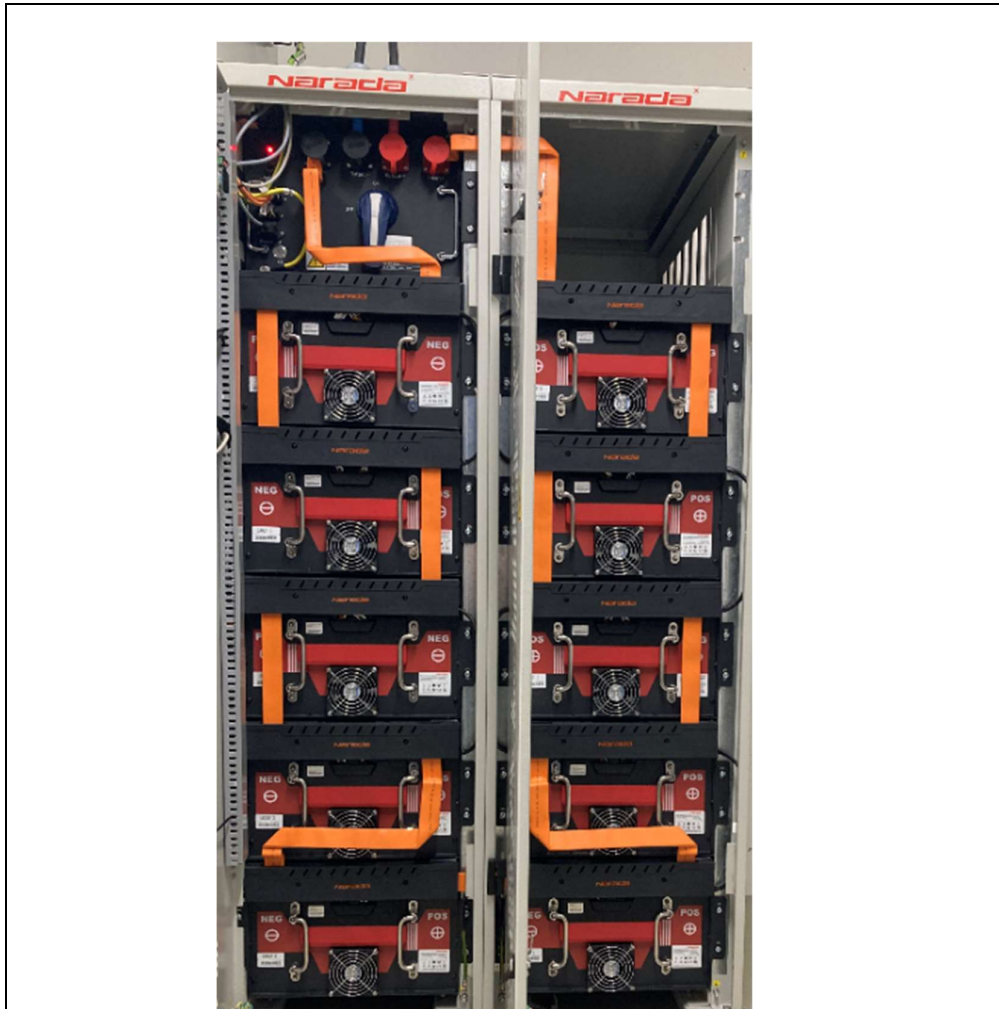
Abb. 27: Beispielhaftes NARADA Rack
