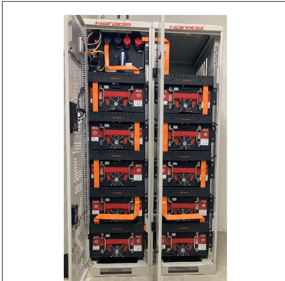
Abb. 8 Anordnung Batteriemodule und Modulverbinder
